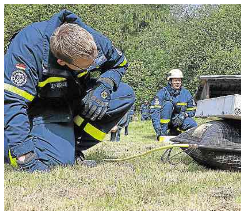
Um Personen und Wertgegenstände zu bergen, müssen schwere Platten angehoben werden. Dazu dient ein „aufblasbares Kissen“.
